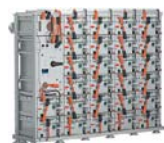
ИБП и системы накопления энергии
